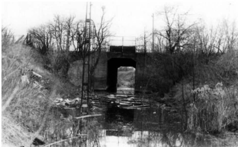
Il. 4. Wiadukt pod torami prowadzącymi z terminala kontenerowego przy ul. Ordona 2A do stacji Warszawa Główna Towarowa – zasypany wraz z całym wykopem w 2008 r.
